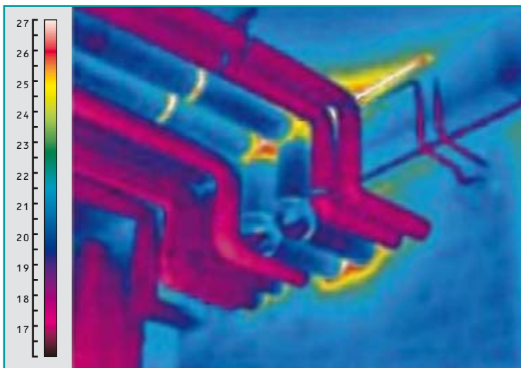
Isolationen an Rohleitungen
